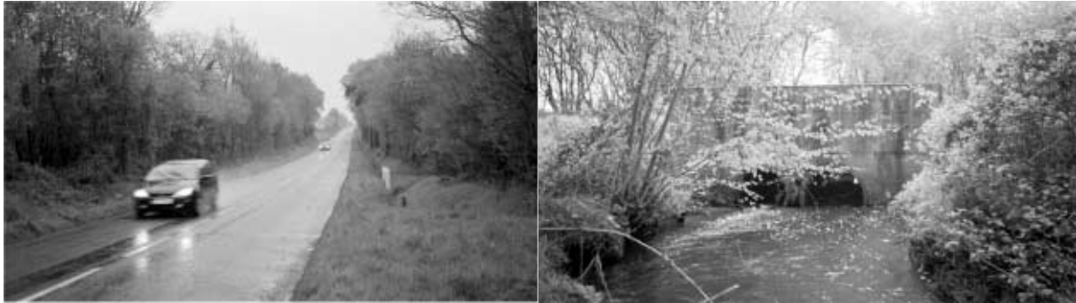
Exemple d'ouvrage à risque significatif (RD 782 dans le Morbihan) : section de route rectiligne, faible encaissement du cours d'eau, vitesse élevée des véhicules, faible gabarit de l'ouvrage (photos L. Lafontaine).
