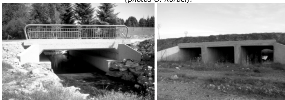
banquette en béton : France (Bretagne) ou Catalogne (Rés. Nat. Aiguamolls de l'Empordà) (photos L. Lafontaine & Minuartia).
